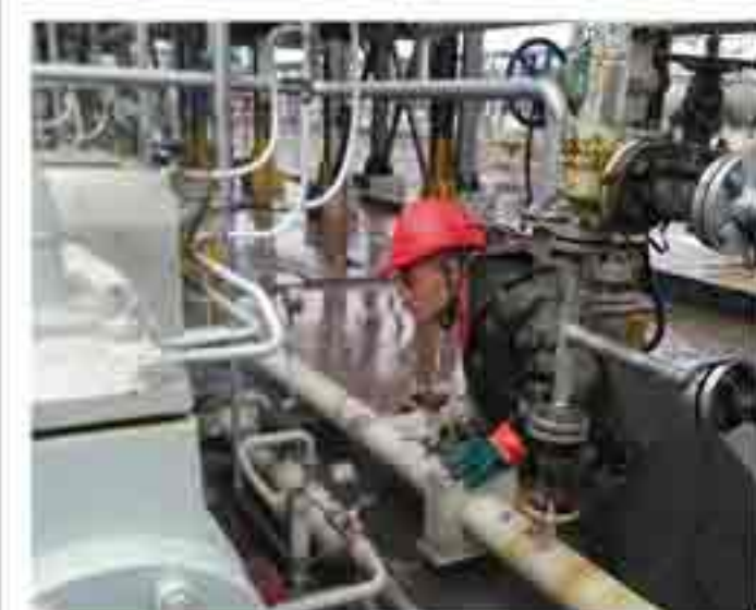
主题：聚精会神做好巡检工作 时间：2023年7月15日 地点：2A加氢压缩机 说明：循环氢压缩机作为装置的重要设备，它也是巡检重点，雨天视线不好，外操李国辉，弯下身子聚精会神确认润滑油液位，确保重要设备能良好运行。 李聪聪 / 生产运行中心
