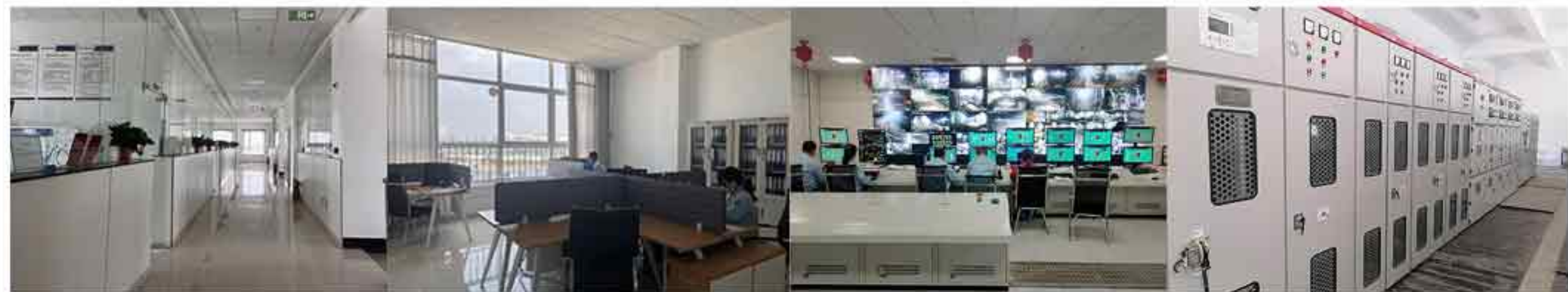
(图为投用后的化验楼内景、中控楼内景及配电室内景)
